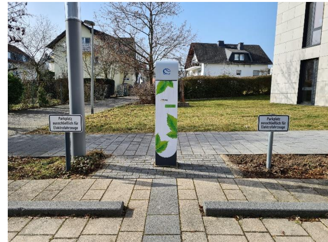
Seit 2014 E-Ladesäule der Süwag auf Rathausparkplatz/Bahnhofstraße
