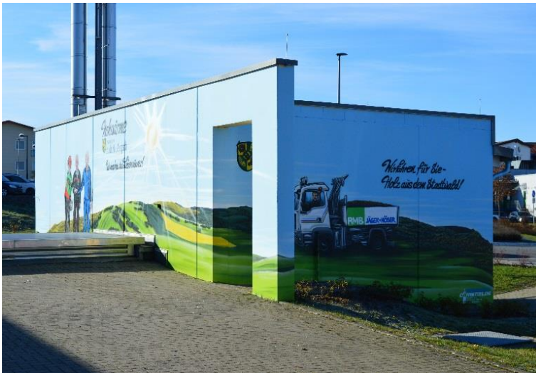
Holzchipschnitzel-Heizanlage mit Hackschnitzelbunker und Ölspitzenlastkessel als Redundanz
