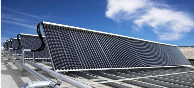
Vakuum Röhrenkollektorfeld Quelle: Ritter Solar XL
