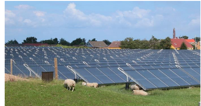
Flachkollektoren Quelle: Projekt Nahwärmeversorgung Marstal
